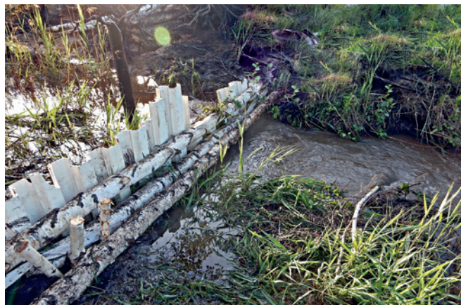
Рис. 91. Промойна под перемычкой из шпунта Ларсена. Видно бурление выходящей воды справа от перемычки
